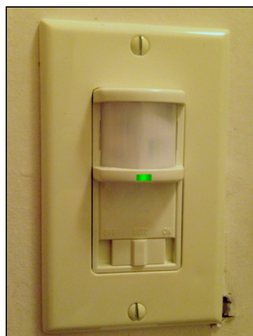
รูปที่ 2.8 สวิตช์ไฟภายในอาคารที่ติดตั้งเซนเซอร์ตรวจจับการครอบครองแบบ PIR
