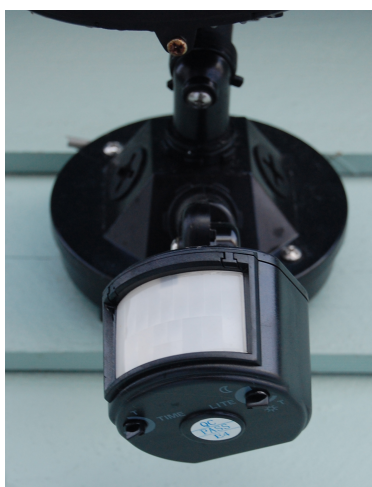
รูปที่ 2.6 เครื่องตรวจจับความเคลื่อนไหว PIR ใช้สำหรับควบคุมไฟภายนอกอาคารแบบอัตโนมัติ
