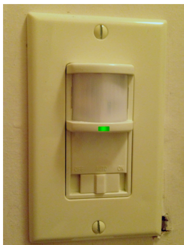
รูปที่ 2.8 สวิตช์ไฟภายในอาคารที่ติดตั้งเซ็นเซอร์ตรวจจับการเคลื่อนไหวแบบ PIR
